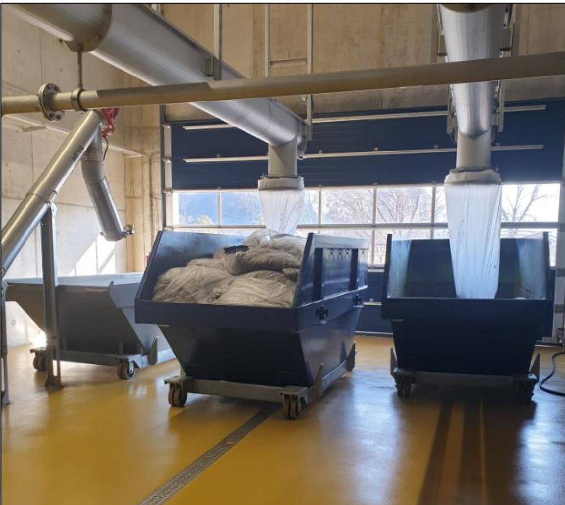
Das Rechengut wird mittels Schlauchsäcke in die Rechengutmulden befördert
